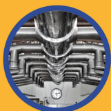
Ductos de ventilación
